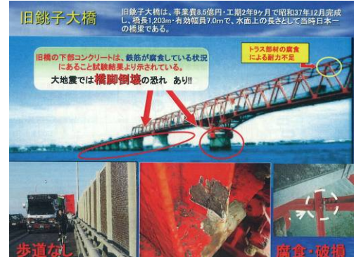
旧銚子大橋腐食・破損
